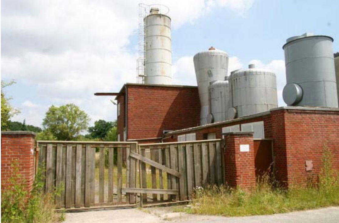
Die ehemalige BWS-Färberei Nünningmühle wird unter der Regie des AAV in Hattingen jetzt saniert. (Foto: Archiv)
